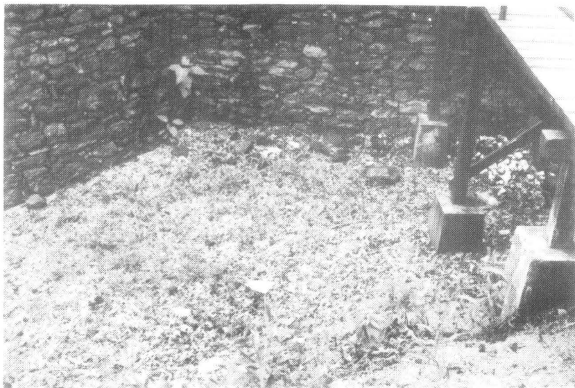
Foto 45. Sampah yang terlihat di bawah jembatan benteng Bukit Kursi, sepertinya dibuang dengan sengaja di bawah jembatan ini.
