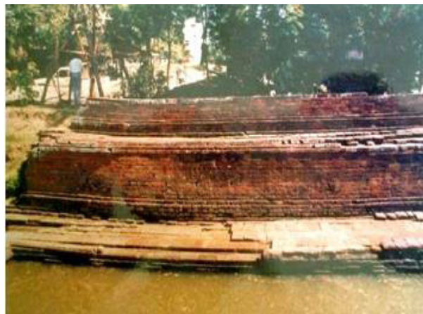
Foto 21. Kerusakan di bagian dinding teras sisi barat
