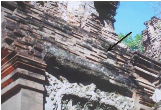
Foto 54. Profil di bagian ambang atas yang tidak diketahui bentuknya
