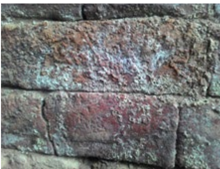
Foto 2. Efflorescence pada Permukaan Bata
