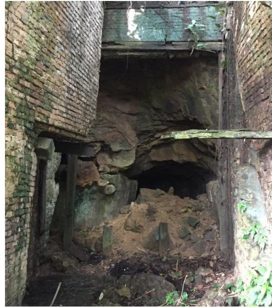
Foto 6. 7 Bangunan tambang Ost Borneo Maskapai yang runtuh akibat tanahnya tererosi air (Dok. Muhammad Nur, 2020)
