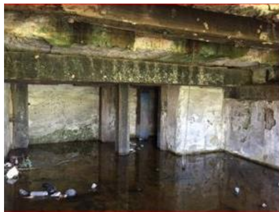
Foto 6. 10 kondisi dalam ruangan bunker yang terendam banjir (Dok. Muhammad Nur, 2020)
