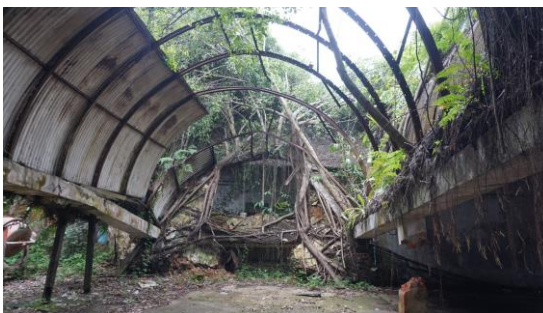
Foto 3. 46 Kondisi atap Gedung Atap Lengkung (Dok. BPCB Kalimantan Timur, 2020)
