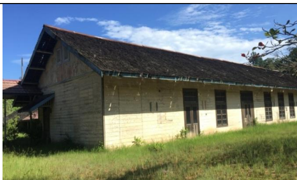
Foto 6. 12 Kondisi bangunan Klinik Pertamina dimana permukaan tanahnya lebih tinggi dari pada lantai gedung. (Dok. Muhammad Nur, 2020)
