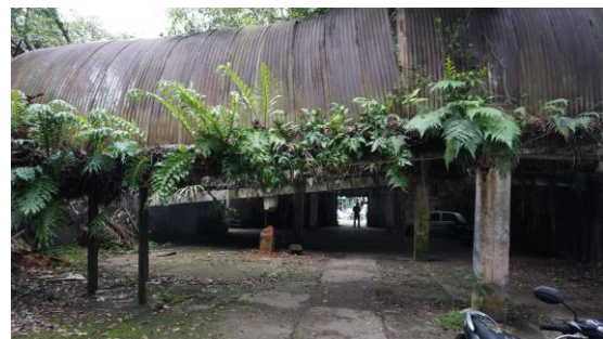
Foto 3. 47 Kondisi atap Gedung Atap Lengkung (Dok. BPCB Kalimantan Timur, 2020)
