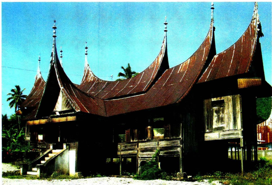
Foto 16. Kerusakan Arsitektural Rumah Adat Minangkabau Solok Selatan Sumatera Barat
