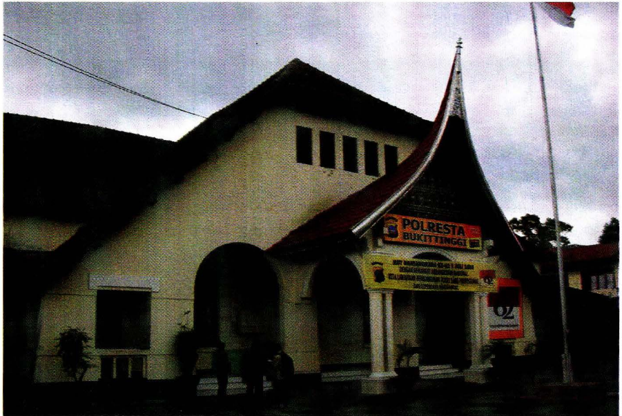
Foto 19. Kerusakan Arsitektural Bangunan Mapolresta Bukittinggi Sumatera Barat
