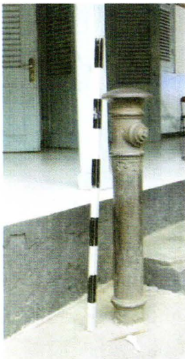
Pipa hydrant di sisi selatan selasar bangunan kedua SDN Baros Mandiri 4
