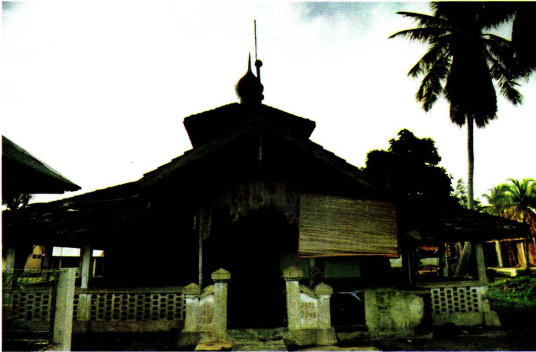
Masjid Madinah tampak depan. Kondisinya kini tidak terawat dan terbengkalai
