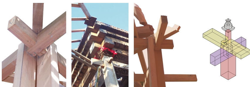
Gambar 1,2,3. Pada area pertemuan konstruksi kayu akan terjadi pengurangan luas tampang, terjadinya penyimpangan arah serat dan terbatasnya luas sambungan (foto : penulis)
