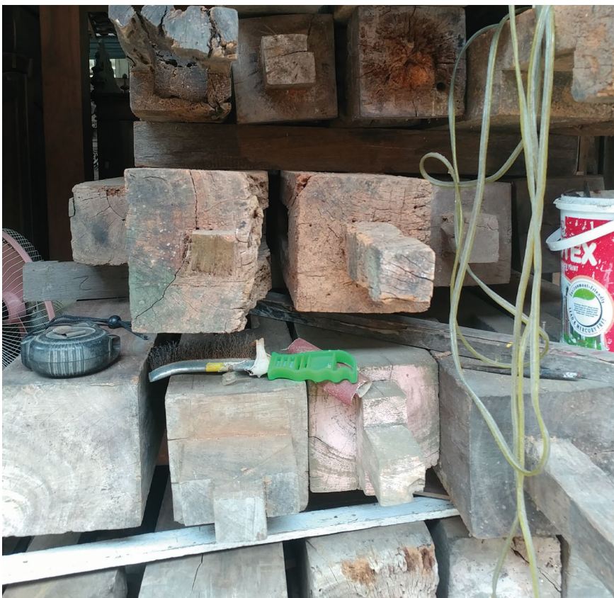
Foto 3. Jenis kerusakan biologi dan kimia pada bahan kayu (sumber: Andi Putranto, 2024)
