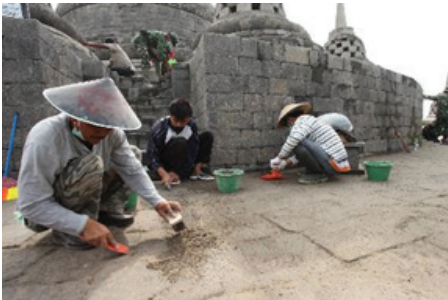
Pembersihan kering pada lantai stupa teras (dok : BK Borobudur, 2014)
