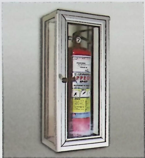
Gambar 5.30 – Alat Pemadam Api Ringan (APAR) harus Siap Digunakan untuk Menangani Risiko Api dan Kebakaran sebagai Agen Kerusakan
