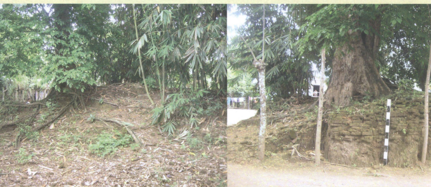
Foto 54 . Kondisi struktur bata pada dinding Bastion Jonggoa, ditumbuhi pepohonan yang dapat mengancam kelestariannya (Dokumentasi BP3 Makassar, 2010)
