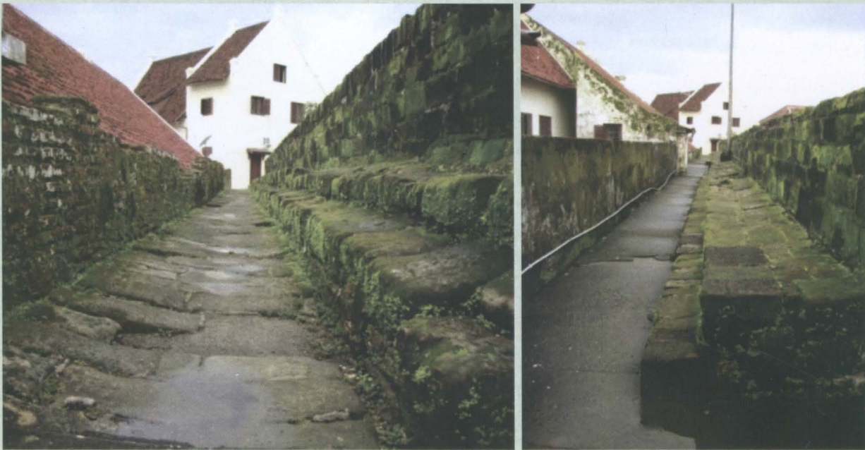
Foto 40, 41 : Lumut pada dinding bangunan dan dinding benteng
