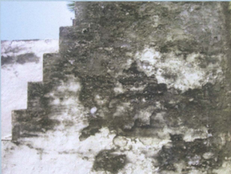
Foto 39 : Algae pada dinding bangunan
