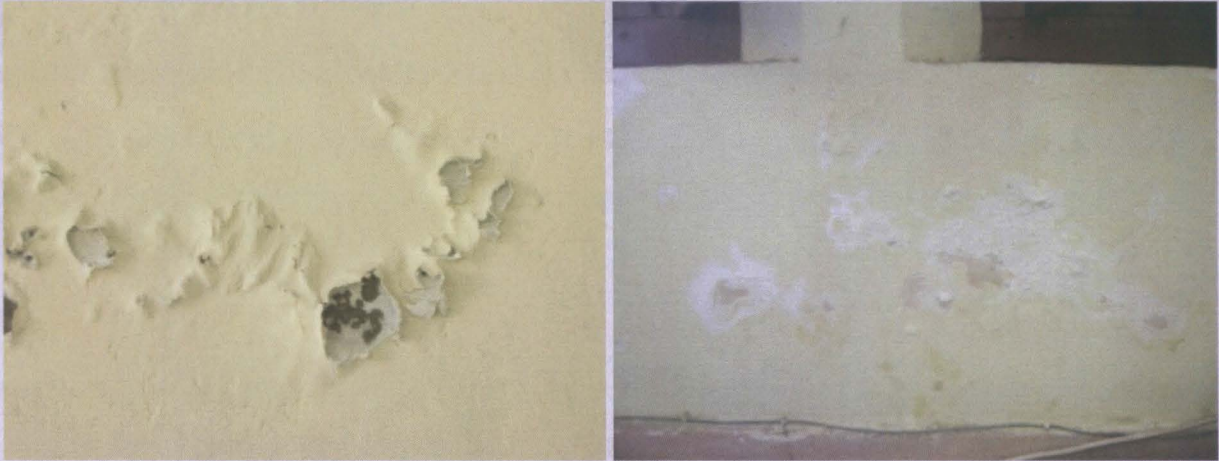
Foto 42, 43 : Contoh penggaraman yang terjadi pada dinding bangunan
